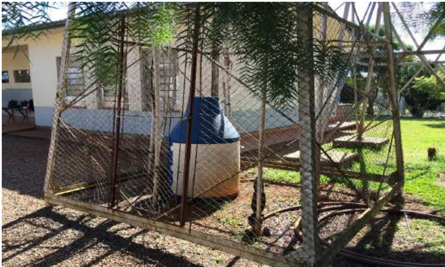
Foto 4 - Sistema de tratamento - dosador cloro
