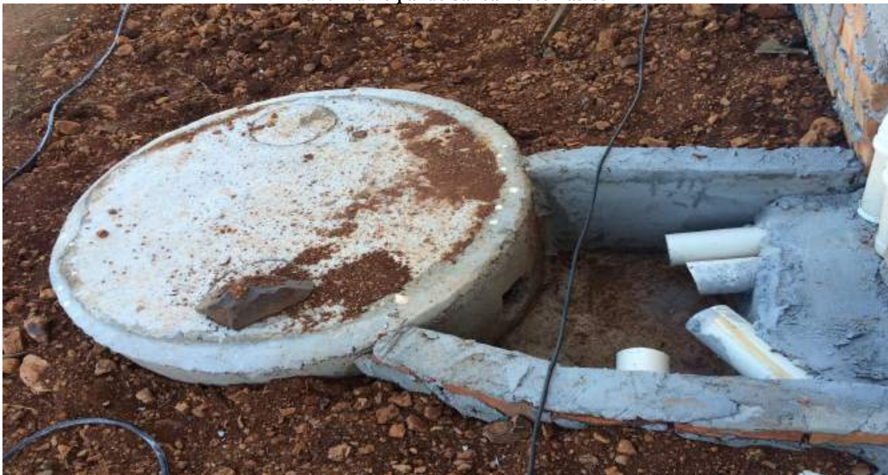
Foto 3 - Vista parcial de sistema de tratamento de esgoto individual – fossa e filtro.
