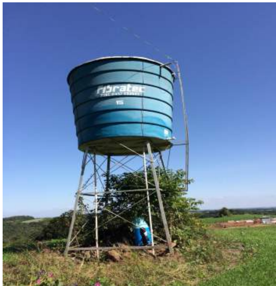
Foto 6 - Sistema de reservatórios zona rural com tratamento.
